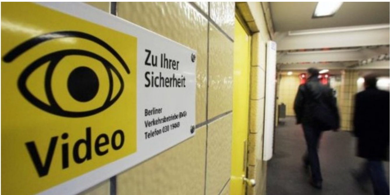
In 42 Bahnhöfen werden neue Kameras installiert.
