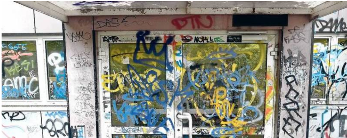
Die Turnhalle des Andreas-Gymnasiums in Friedrichshain gehört zu den prägnanten Beispielen für die schleppende Schulsanierung. FOTO: KAI-UWE HEINRICH
